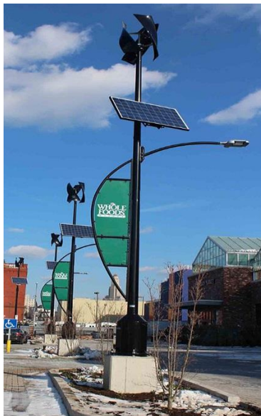
Figur 14: Lyktestolpe med vindturbin, solceller og batteripakke
